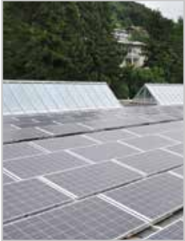
Die Photovoltaik-anlage am Dach des Val Blu.
